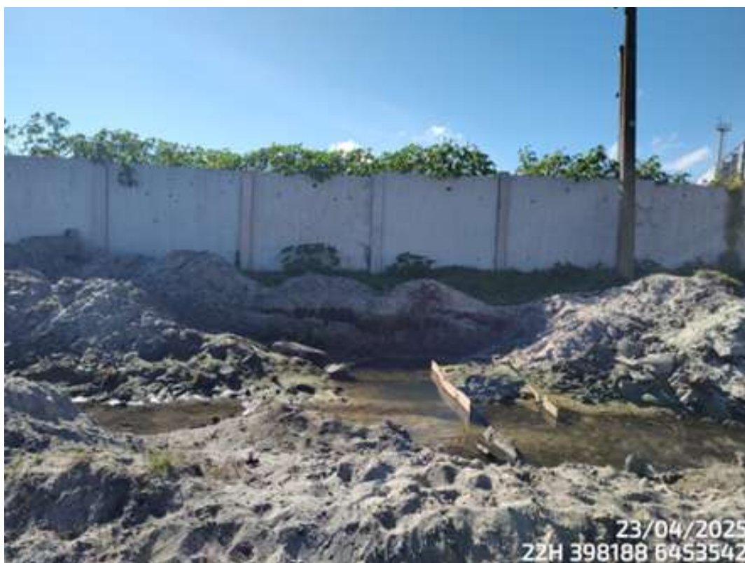
Foto: Esgoto a céu aberto em frente as residências das entrevistas 9, 10 e 11, Bairro Santa Tereza.
